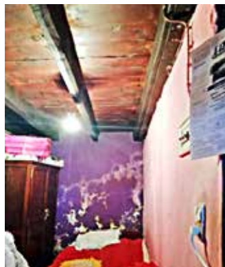
Figura 2 - Efeito da humidade nas paredes
