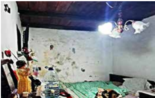
Figura 5 - Habitação com paredes degradadas
