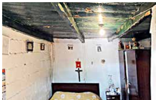
Figura 8 - Habitação com fissuras no teto
